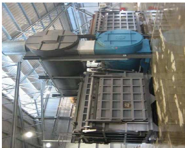
Рис.15 Установка для термического уничтожения отходов «BOS» (США)
