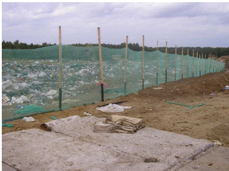
Рис.5 Защитно-улавливающая сетка на рекультивируемой свалке у с.Новоалександрово. 2008г.
